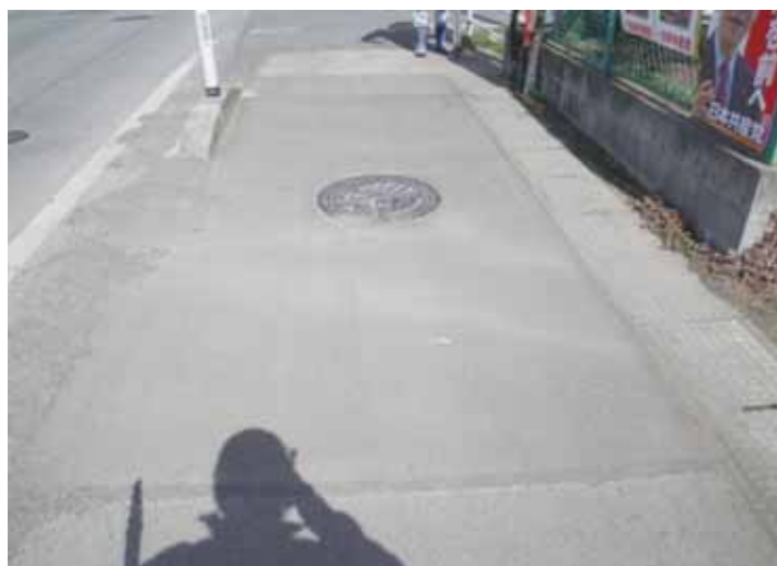
写真 6-3 測定箇所（対策済み No.95 マンホール）
