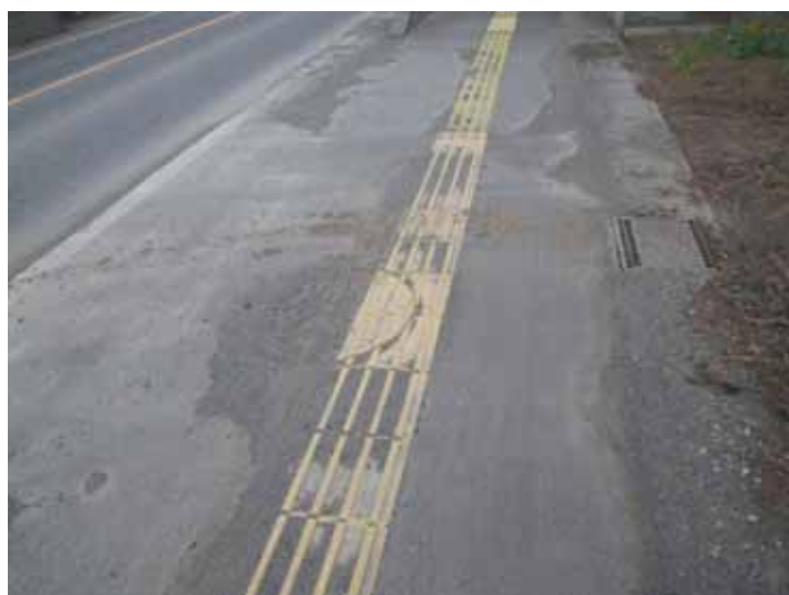
写真 6-1 測定箇所（対策済み No.93 マンホール）
