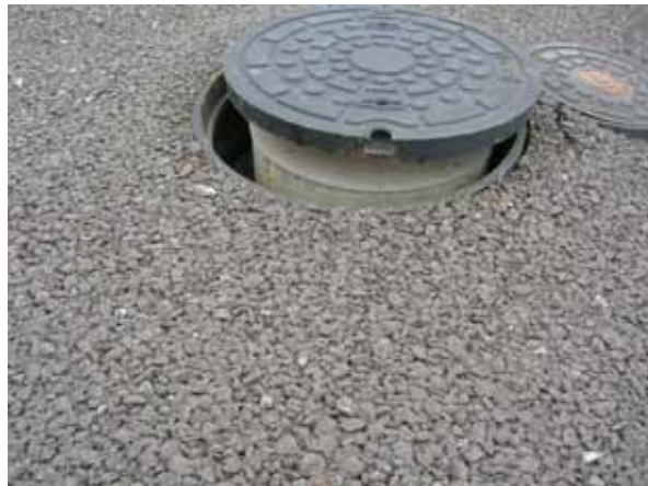
写真 6-63 塩ビマンホールの突出 2
