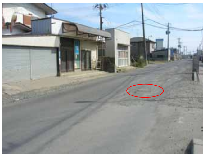
写真 6-66 測定箇所（対策済み No.33-1 マンホール）
