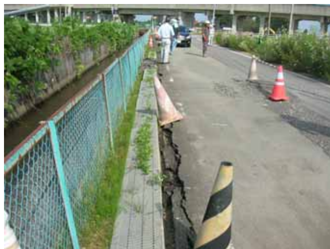
写真 6-19 フェンスの傾き
