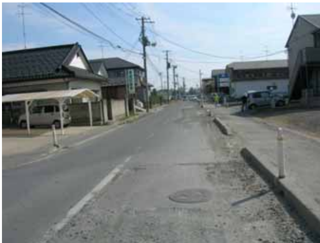
写真 6-76 測定箇所（対策済み No.1-1 マンホール）
