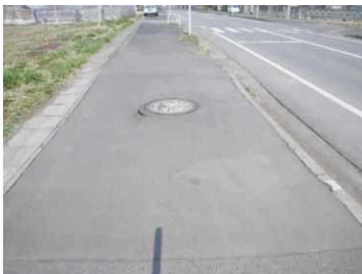
写真 6-41 測定箇所（対策済み No.57 マンホール）
