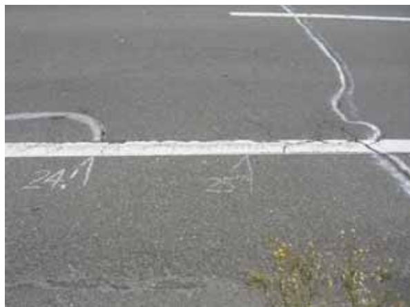
写真 6-50 No.56 と No.8079 周辺の路面状況 2
