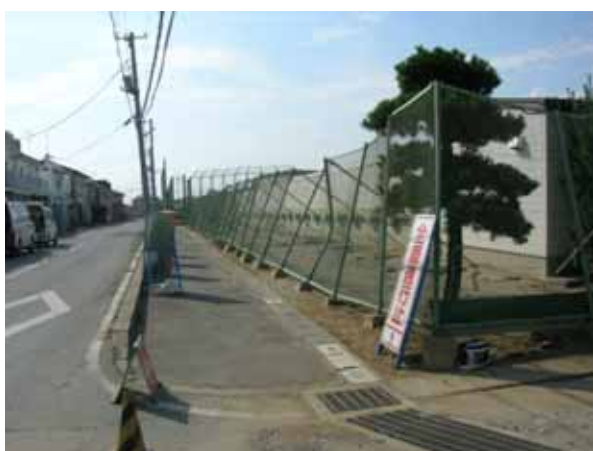
写真 6-85 傾いているフェンス（矢本第二中学校）
