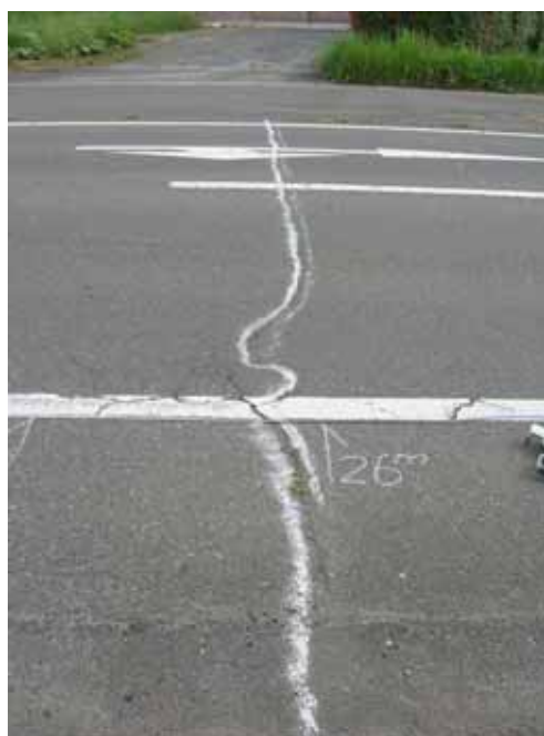
写真 6-52 No.56 と No.8079 周辺の路面状況 4
