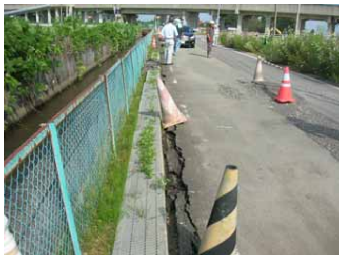
写真 6-14 舗装端部の亀裂
