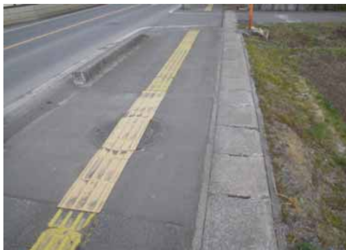
写真 6-2 測定箇所（対策済み No.94 マンホール）
