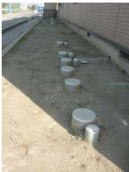
写真 6-86 アパートの柵の隆起
