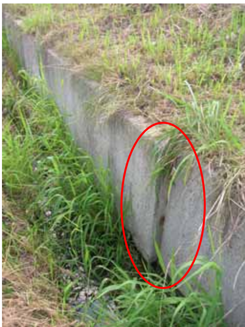
写真 6-18 擁壁の接続部分の段差
