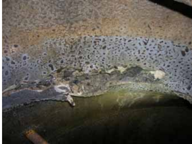
写真 6-29 最下部の直壁部分のコンクリート肌落ちその 1
