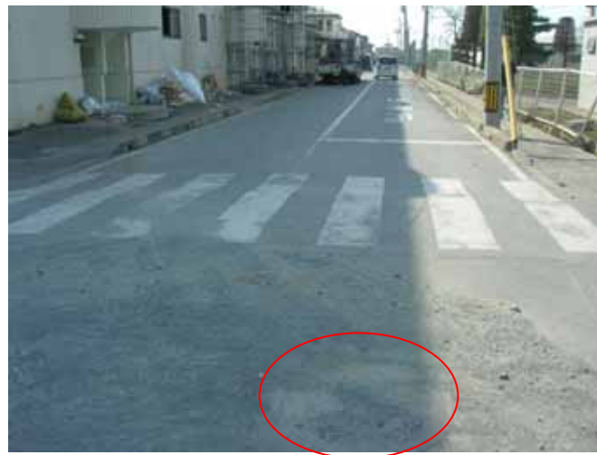
写真 6-73 測定箇所（対策済み No.21-1 マンホール）
