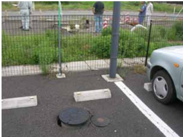
写真 6-62 塩ビマンホールの突出 1
