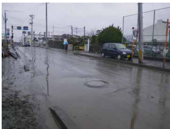
写真 6-65 測定箇所（対策済み No.32-1 マンホール）
