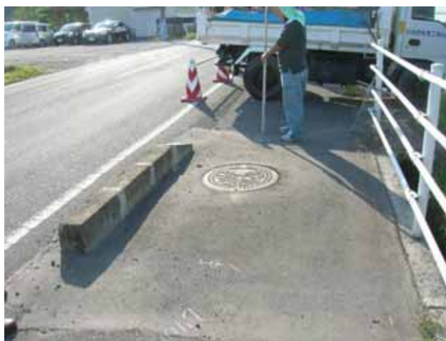
写真 6-20 測定箇所（対策済み No.185-1 マンホール）
