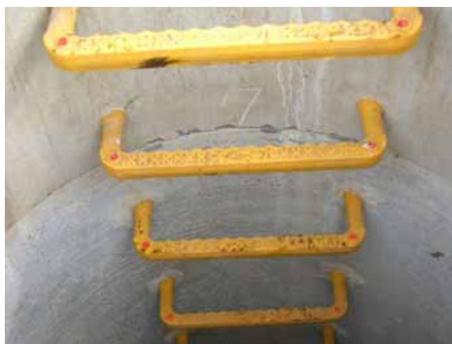
写真 6-46 直壁接続部分のコンクリートの欠け
