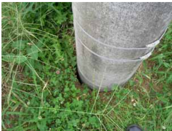
写真 6-64 電柱の周りの空洞
