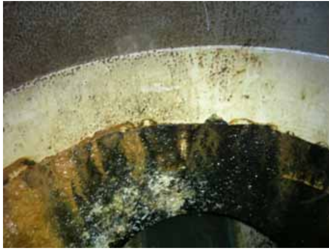
写真 6-44 最下部の直壁部分のコンクリート肌落ち
