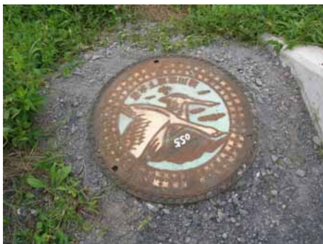
写真 6-40 測定箇所（対策済み No.55 マンホール）
