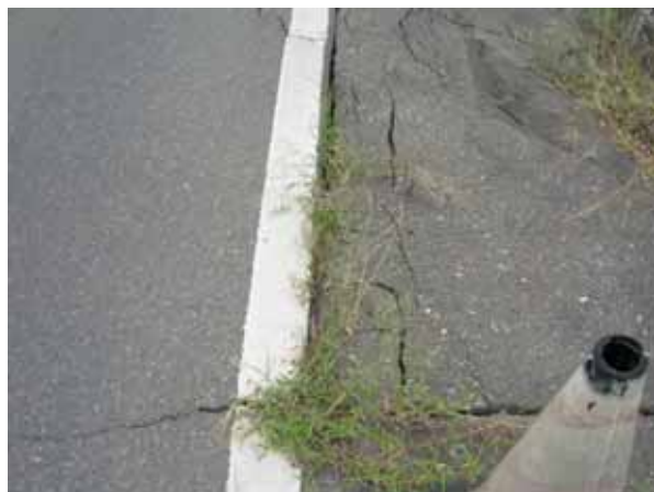
写真 6-51 No.56 と No.8079 周辺の路面状況 3
