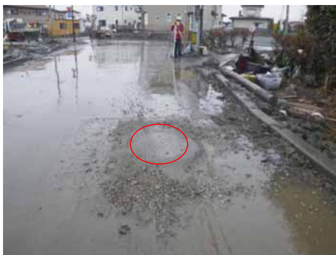
写真 6-68 測定箇所（対策済み No.48-1 マンホール）
