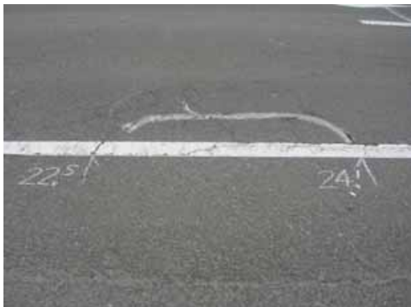
写真 6-49 No.56 と No.8079 周辺の路面状況 1
