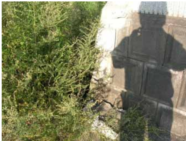
写真 6-38 ブロック破損状況
