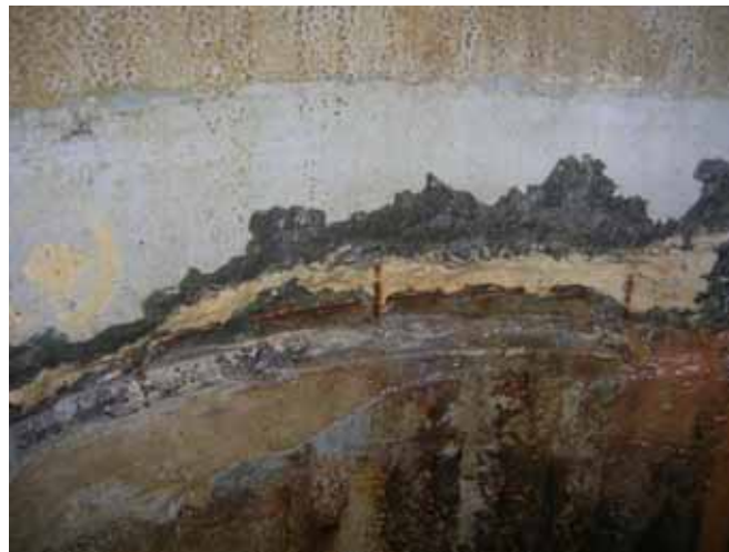
写真 6-30 最下部の直壁部分のコンクリート肌落ちその 1
