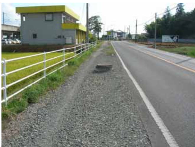
写真 6-13 舗装が撤去されている状況
