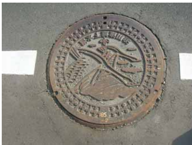
写真 6-21 測定箇所（対策済み No.185-2 マンホール）
