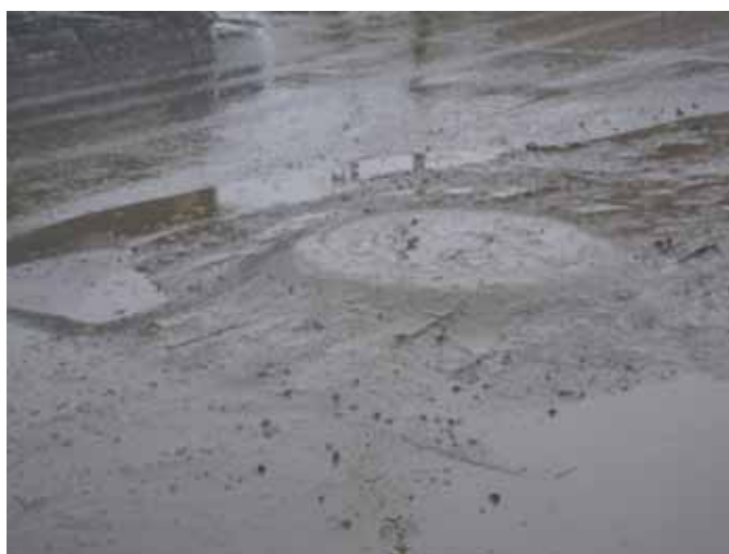
写真 6-67 測定箇所（対策済み No.45-1 マンホール）
