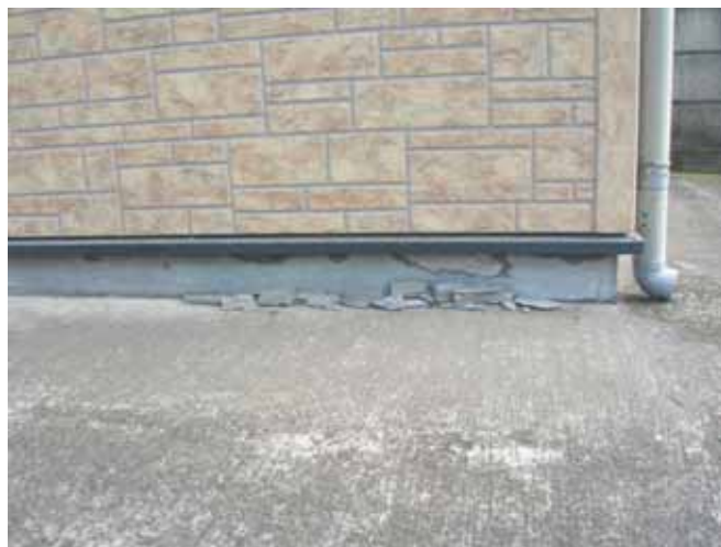
写真 6-17 No.95 マンホール周辺構造物の被災状況
