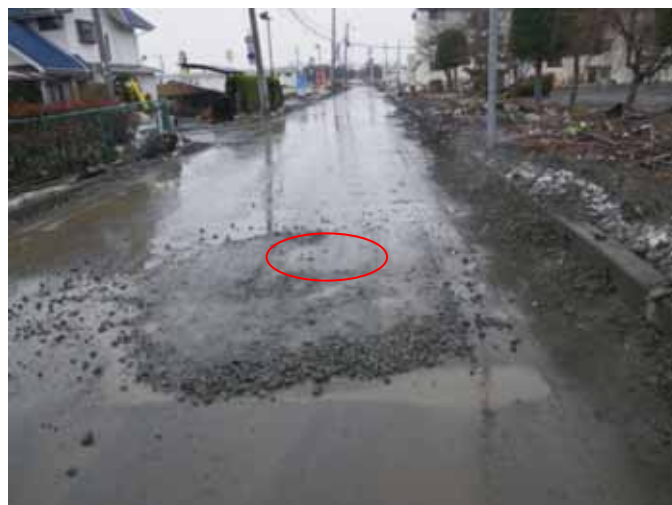
写真 6-74 測定箇所（対策済み No.21-2 マンホール）
