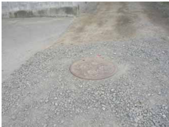
写真 6-83 No.32-1-2 付近の路面状態
