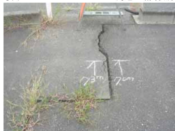
写真 6-53 No.56 と No.8079 周辺の路面状況 5
