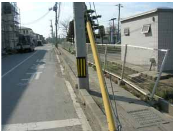
写真 6-84 傾いているフェンス（矢本第二中学校）
